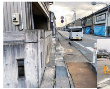
写真-6 液状化による側溝の損傷と沈下状況
