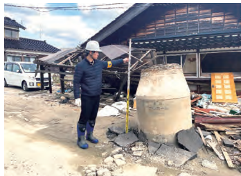
写真-1 マンホールの浮き上がり
