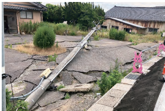
写真-2 内灘町の被災状況
