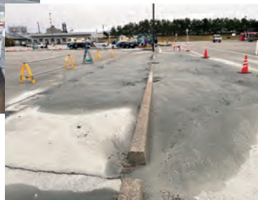
写真-7 魚津港における噴砂の状況
