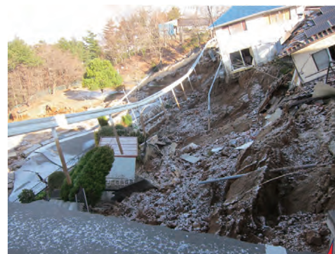
写真-1 地震で盛土が崩れたときの様子(東日本大震災)
