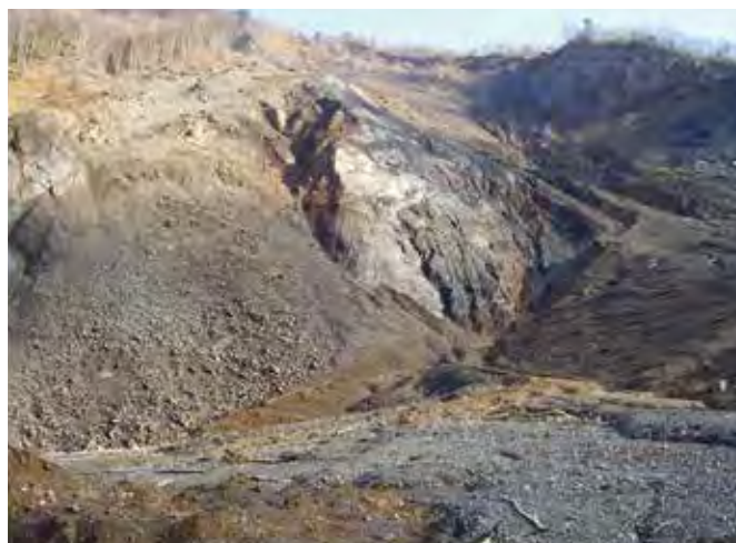
写真-8 奈良県十津川村赤谷地区の斜面崩壊
