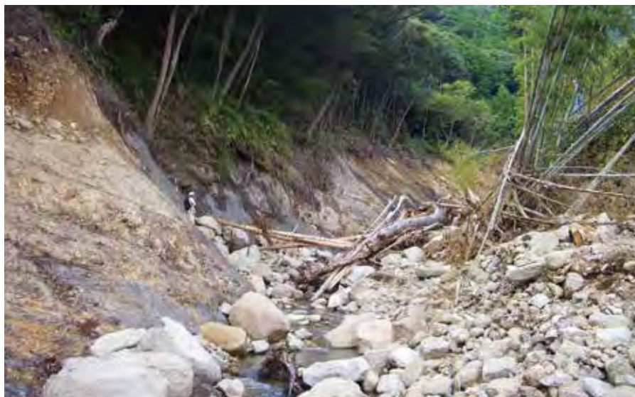
写真-12 和歌山県那智勝浦町の土石流被害
