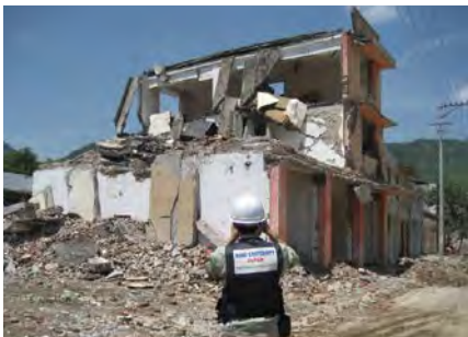
写真11 二階が大きく壊れた建物：北川県擂鼓鎮
