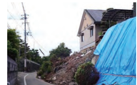
地震により崩壊した擁壁の事例 出典：国土交通省ホームページ 都市局都市安全課資料より抜粋
