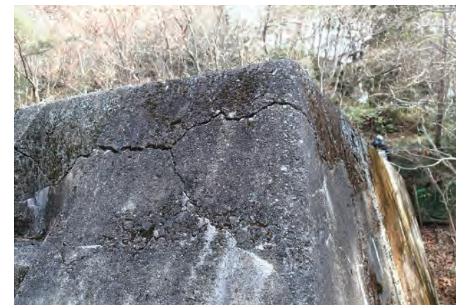
a) コンクリートの劣化によるクラック
