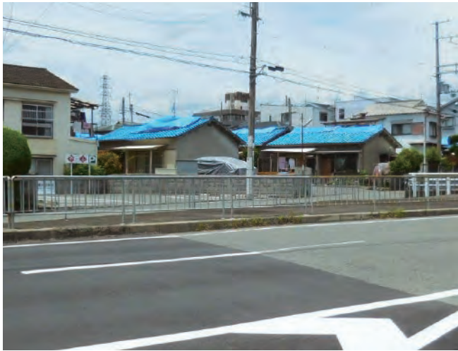
写真-1 屋根瓦の被害状況
