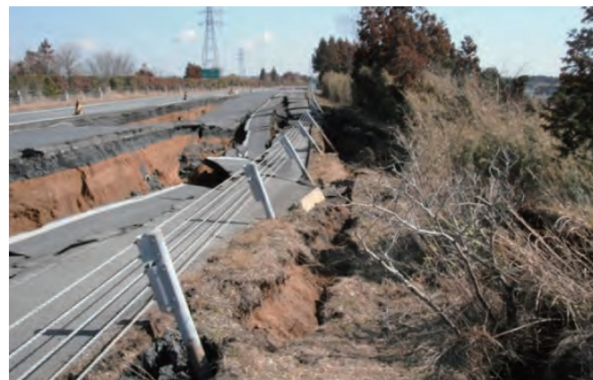
写真-2 常磐自動車道盛土部の崩落 © 基礎地盤コンサルタンツ（株）
