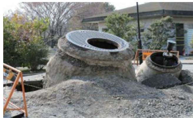
写真-1 液状化により浮き上がったマンホール
