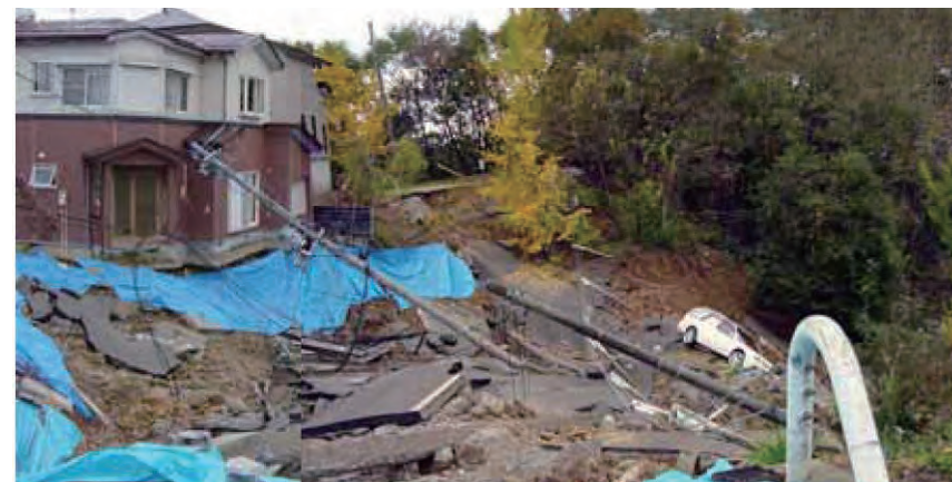
写真-1 谷埋盛土の宅地造成地崩壊 © 基礎地盤コンサルタンツ（株）
